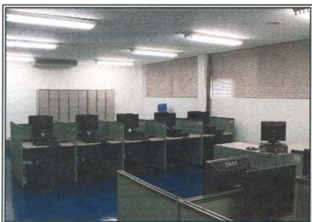
Supervisão/Central de Processamento de Dados
